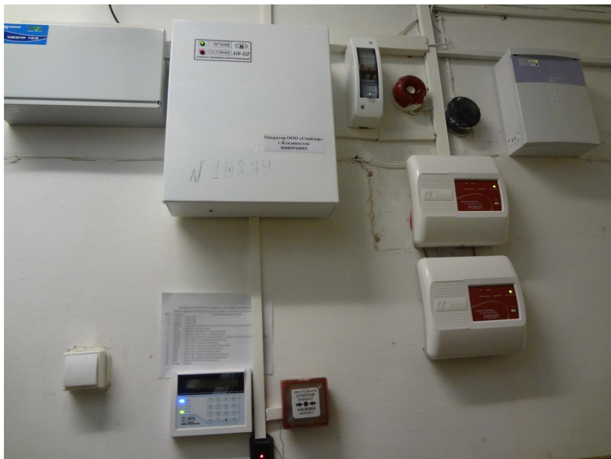
Фото № 15 «Охранно- пожарная сигнализация системы речевого оповещения»
